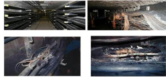
화재로 인해 전소된 공동구 모습(위)과 전기적 발열로 인해 소손된 전력케이블 접속부 사례
